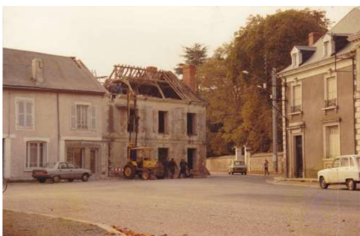
Destruction d'une partie de la gendarmerie 10/1985
