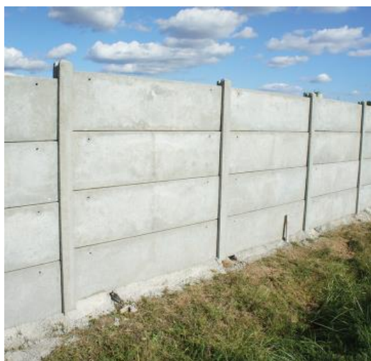
Exemple de plaques ciment lisses interdites.
